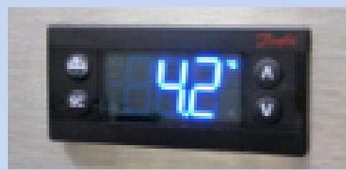
CONTROL DIGITAL DE TEMPERATURA
