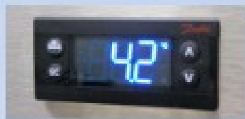
CONTROL DIGITAL DE TEMPERATURA
